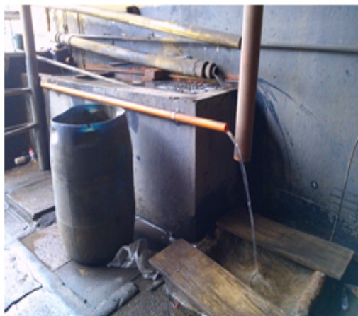
Foto No. 2. Tratamiento y recirculación de agua
