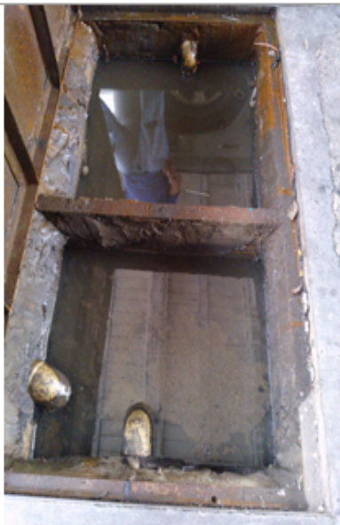
Foto No. 1. Trampa de grasas
