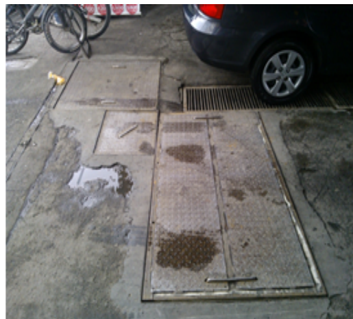
Foto No. 4. Trampa de grasas
